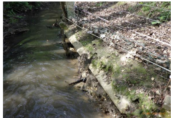
Protection de berge inadaptée
