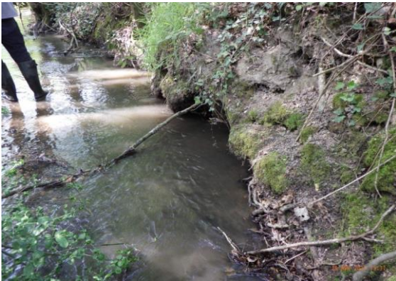
Érosion des berges
