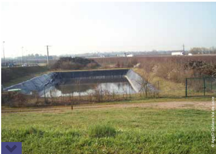
Bassin d'orage sur le territoire de l'Agglo
